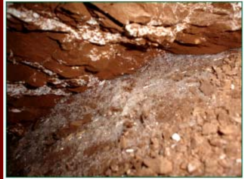
CRISTALES DE YESO PRECIPITADO EN FISURA
